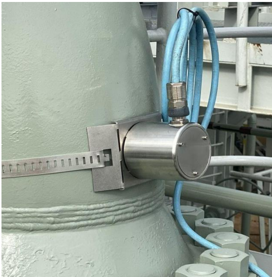
Gambar 9. 21 Aplikasi Sensor Akustik pada Instalasi Migas
