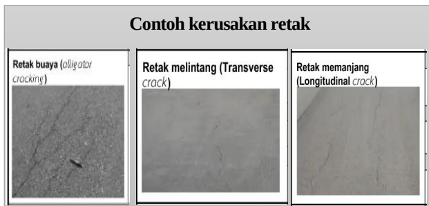
Gambar 7.8. Kerusakan retak pada perkerasan jalan
