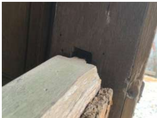
Gambar 2. 8 Kondisi Sambungan Struktur di Rumah Limas Sumber: Tim Kontributor, 2024
