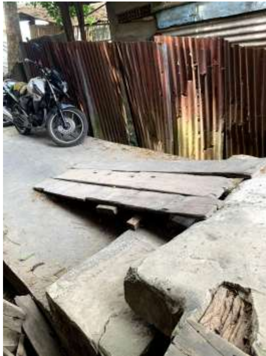
Gambar 1. 5 Kondisi Akses Jalan Kampung Sumber: Tim Tim Kontributor, 2024
