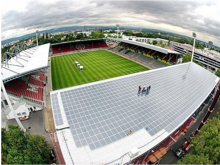
Gambar 4.5. Aplikasi Solar Pnasil di Bruchweg stadium- FSV Mainz 05, Jerman (Sumber : SMA Solar Technology AG)
