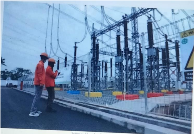
Gambar 1.2. Peningkatan Keandalan (Sumber: https://web.pln.co.id/ )
