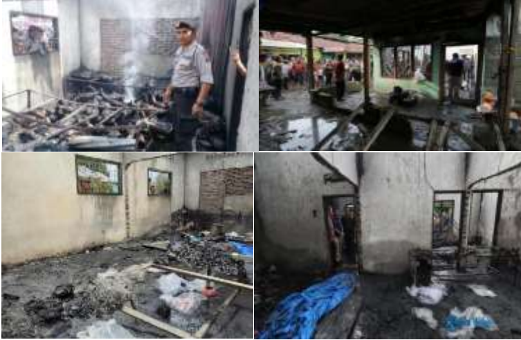
Gambar 5.3 : Kondisi Pabrik Setelah Terbakar
